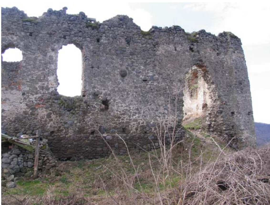
Exteriér severnej steny paláca. Vľavo otvor poškodenej niky, v strede poškodené okno, vpravo rozsiahle poškodenie okenného otvoru, ktorý slúži ako vstup do horného hradu.
