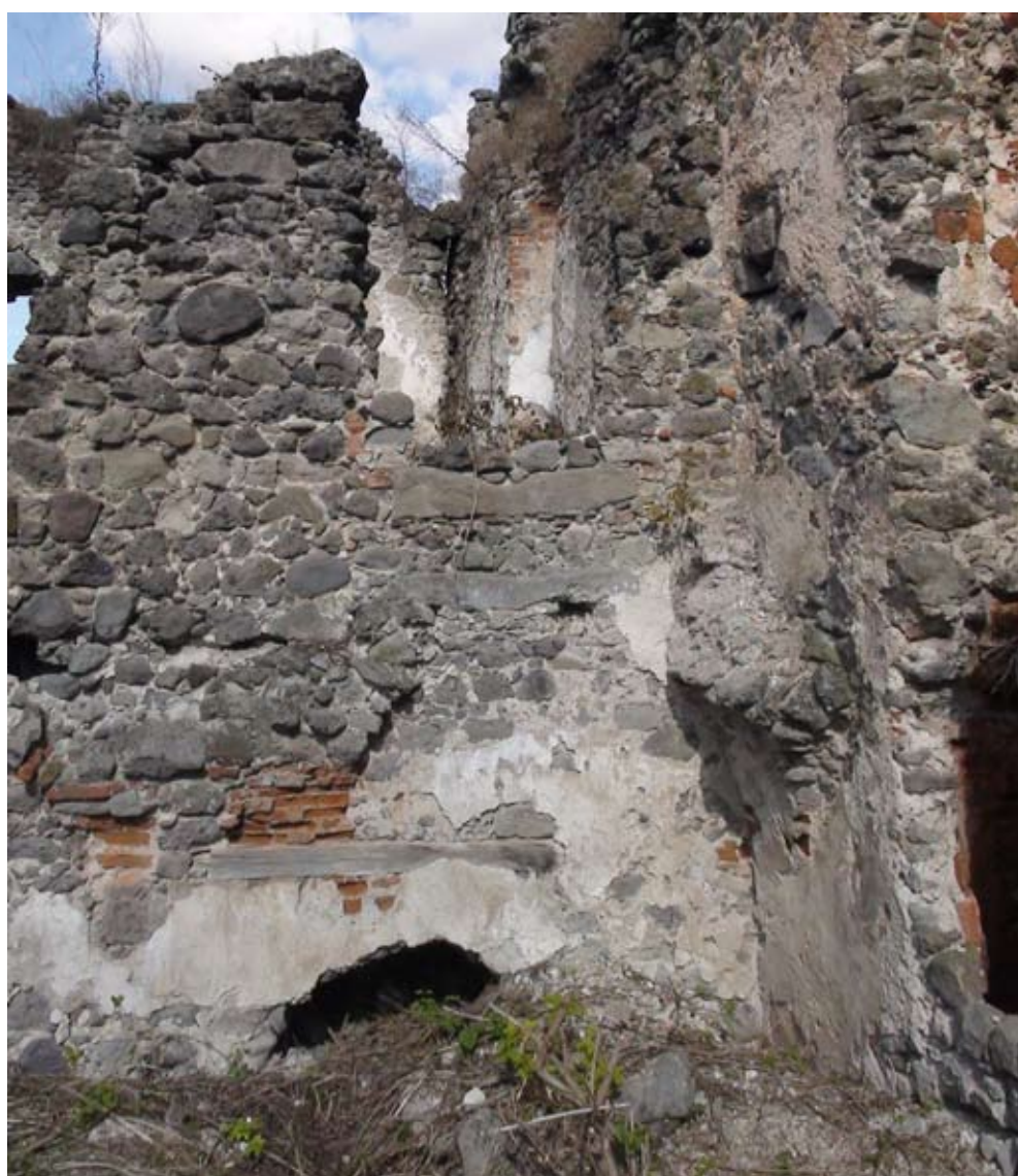
Pozostatky klenby arkádovej chodby na nádvornej exteriérovej strane južnej steny. Súťou sú zasypané vstupné otvory do prízemia.
