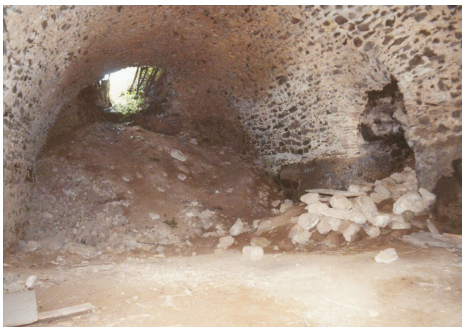
III. vstupná brána - pohľad z pivnice na prerazený otvor v klenbe
