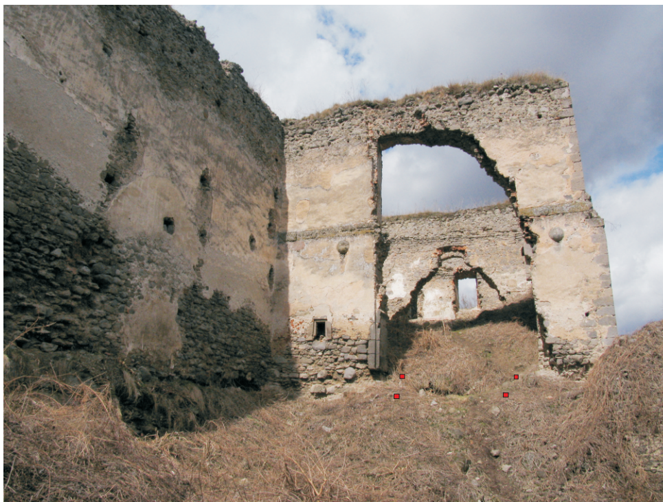
Pohľad na III. vstupnú bránu. Červenou bodkou je označený prerazený otvor do klenby pivnice. Fotografia ukazuje množstvo sutiny, ktorá je nahromadená na klenbe.
