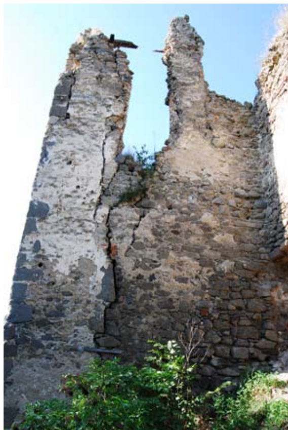
A: Západná veža. Severná stena veže s prasklinami. Vpravo čiastočne vidno otvor výpadnej bránky.
